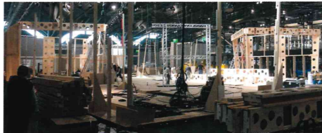
Tag 4: Das Grundgerüst nimmt Form an. Rund 3.360 Stunden waren allein die Schreiner im Einsatz, um jedes einzelne Holzelement mit höchster Genauigkeit und Fingerfertigkeit vorzubereiten.
